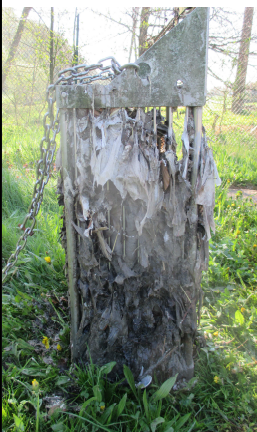
Panier dégrilleur colmaté
