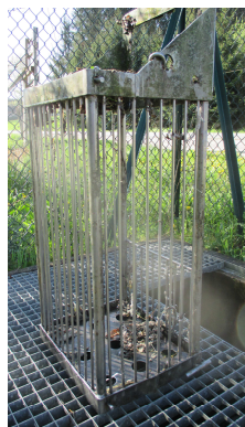
Panier dégrilleur propre
