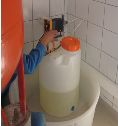
La pompe doseuse régulée d'hypochlorite de sodium (eau de Javel)
